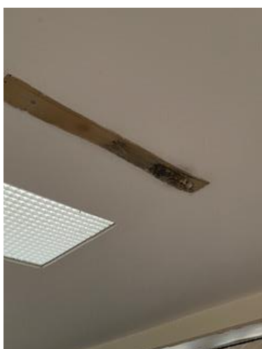
Infiltrations d'eau dans les luminaires de la petite salle
